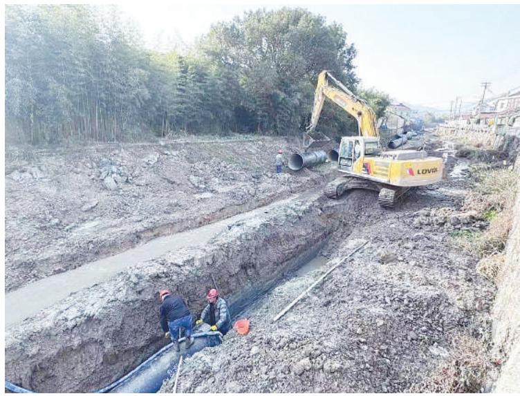
向家弄水库至世南西路原水管道工程施工现场 通讯员 陆佳男
